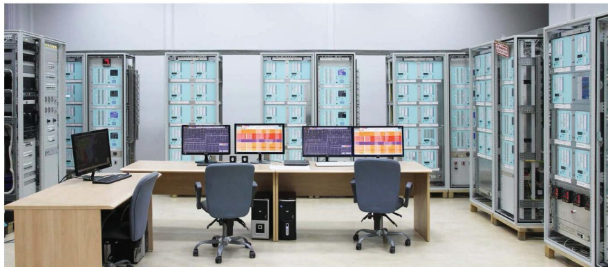
Рис. 2. Испытания на базе полигона НПП «ЭКРА»
